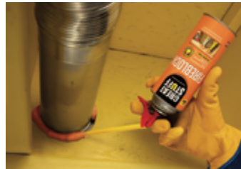
Penetraciones de HVAC
