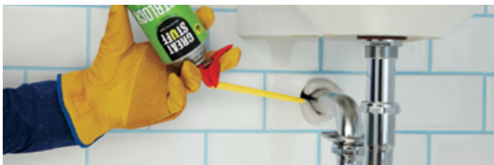
Traversées de plomberie
