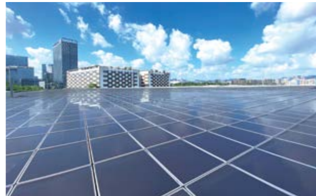
杜邦太阳能（深圳）有限公司屋顶光伏发电组件
