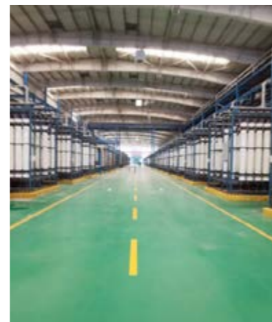
宁东工业园区废水处理设施
